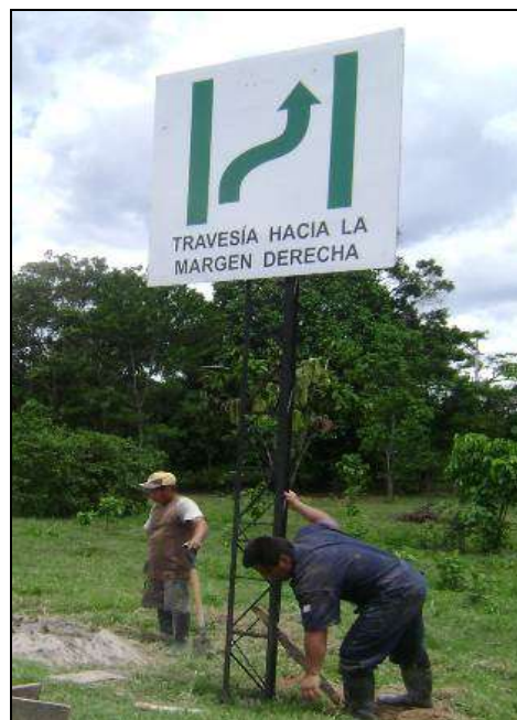
Letrero señalizador de canal río Huallaga
