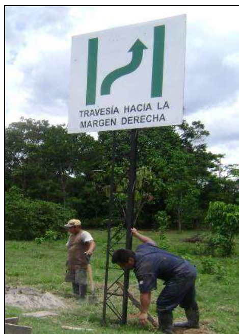
Letrero señalizador de canal río Huallaga
