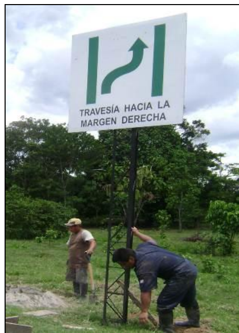
Letrero señalizador de canal río Huallaga
