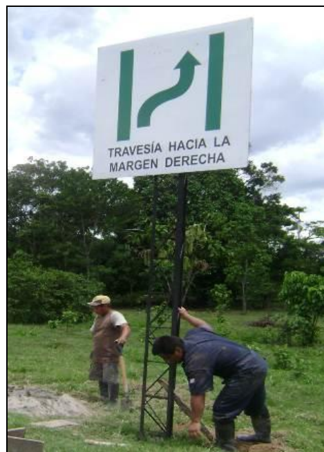
Letrero señalizador de canal río Huallaga
