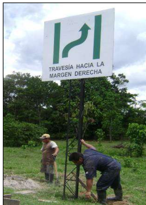
Letrero señalizador de canal río Huallaga
